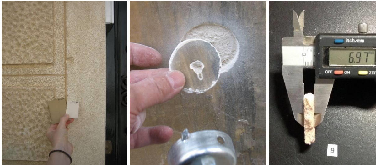
L'estuc varia de color segons la textura, és més dur i té un gruix de 6 a 10 mm damunt l'arrebossat.
